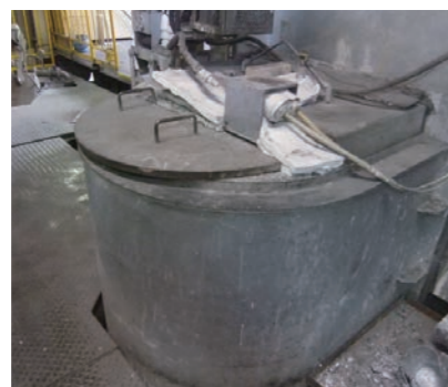
改善後 浸漬管電熱ヒーターに変更し、細かく温度管理を実施。
